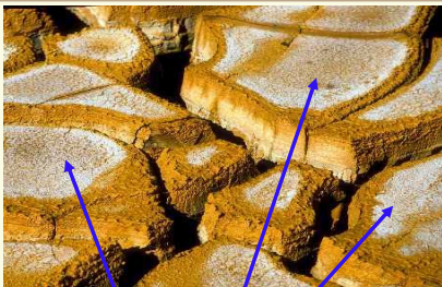
Eflorescências de sais
